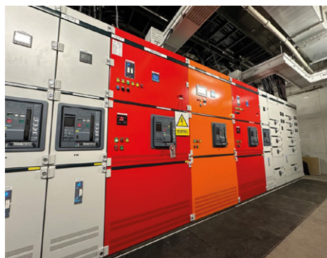
Rys. 5. Nowa rozdzielnica wyposażona w aktywny układ AQ100 z urządzeniami AQ-1000
