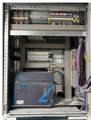
Rys. 4. AQ-1000 zamontowane w polu zasilającym Fig. 4. AQ-1000 mounted in the power supply field
